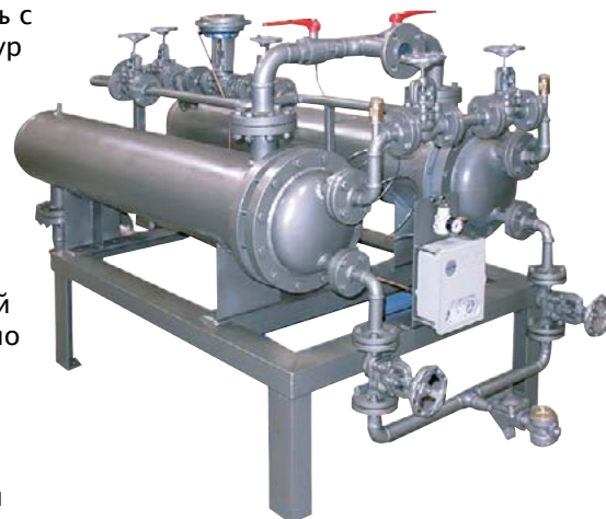
Пример: станция подогрева мазутного топлива
